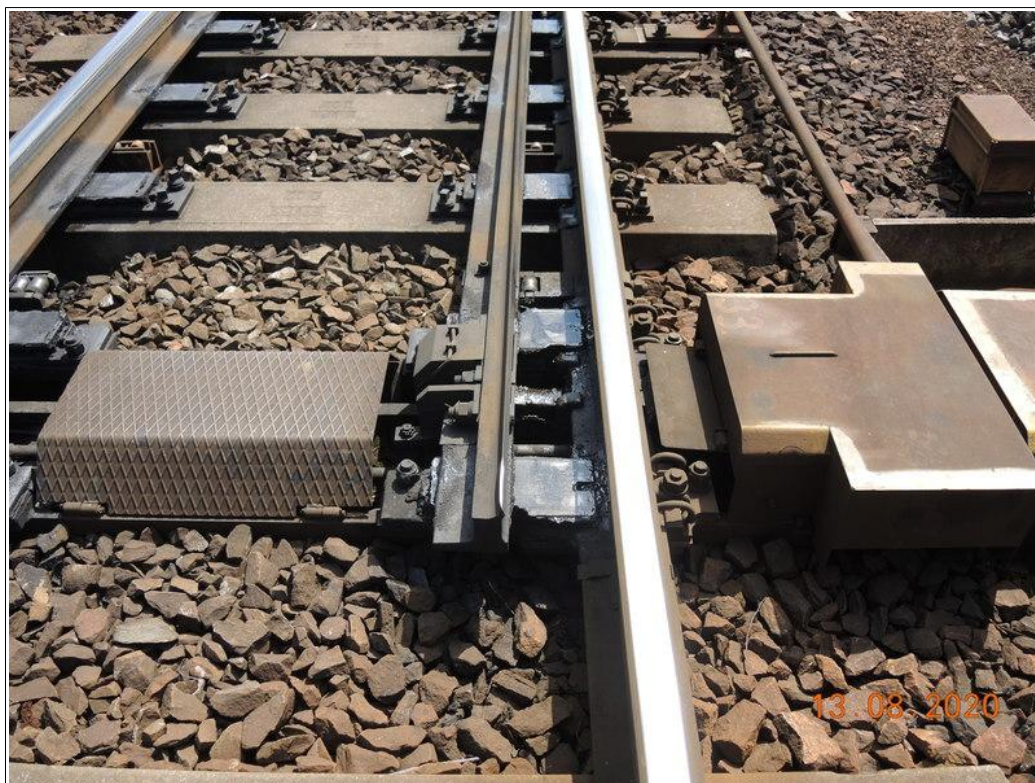
Obr. č. 6: Pravý přímý jazyk výhybky č. 33 žst. Tišnov se stopou otěru pravého předního kola předního podvozku „a“ TDV 51 54 82-40 401-6.
