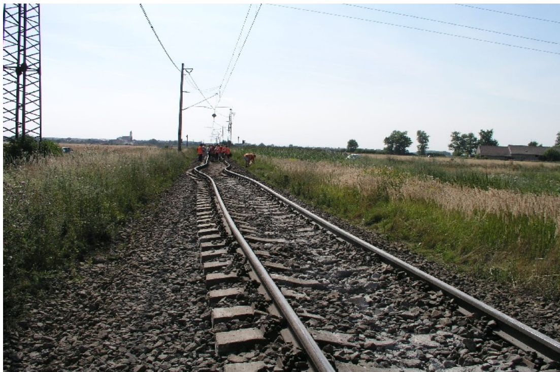
Foto 1: Celkový pohled na místo mimořádné události ve směru do žst. Věžky (proti jízdě Os 4031).
