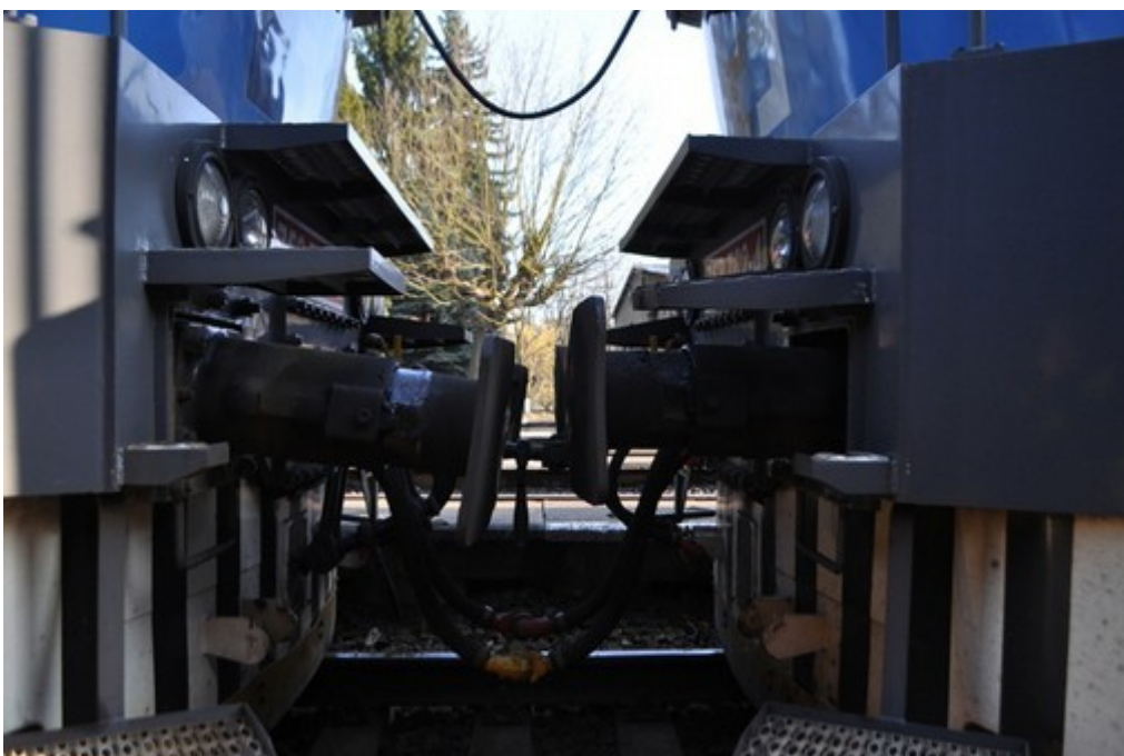
Obr. č. 4: Detail poškození
