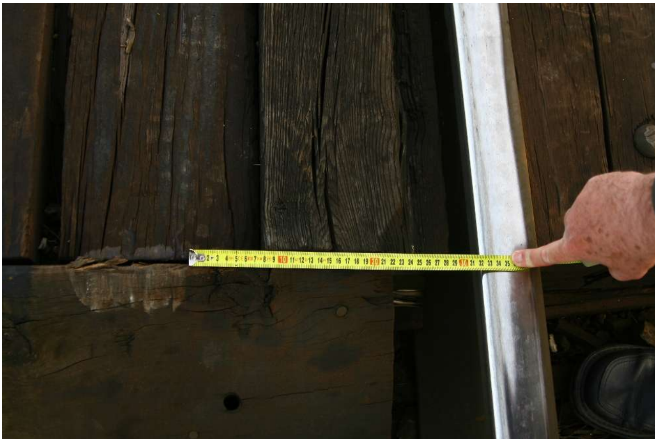
Foto 7: Druhá stopa – tření silentbloku pravé šikmé tyče po dřevěné konstrukci přejezdu
