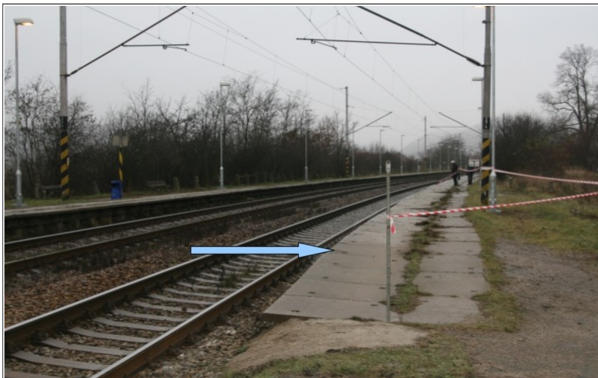
Foto 4: Začátek poškození nástupiště v km 27,832
