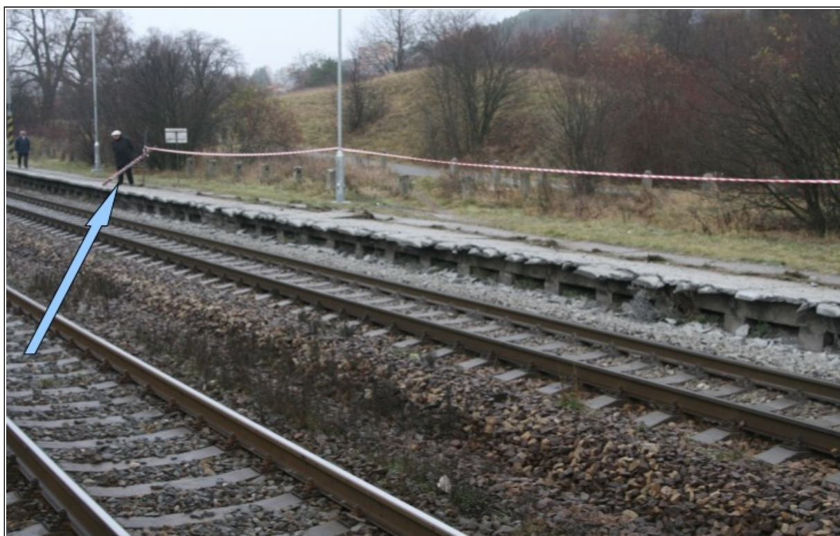
Foto 5: Konec poškození nástupiště v km 27,874
