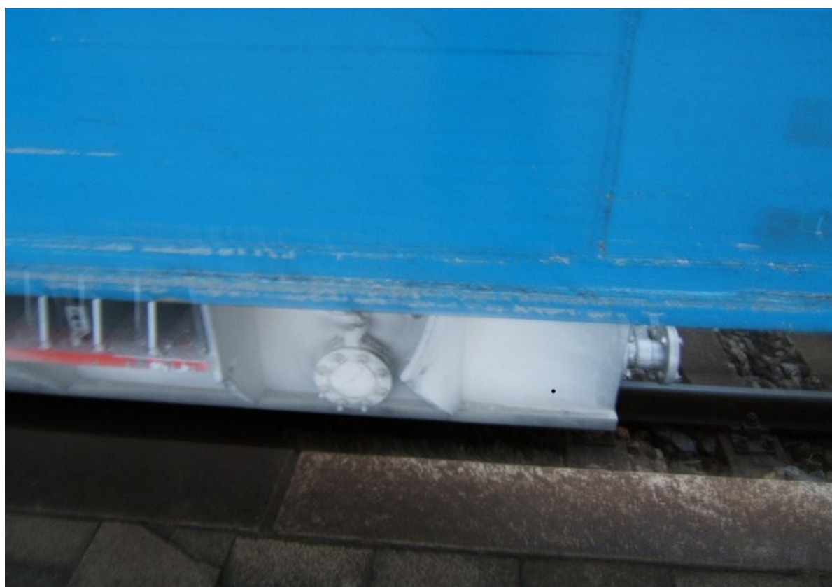
Foto 3: Detail poškozených žebér transformátoru
