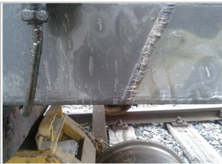
Obr. č. 4: Pohled na únavovými trhlinami (prasklinami) poškozený podélník rámu vozu nad podvozkem (b) TDV 33 51 7984 332-1.
