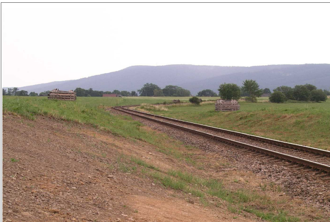
Foto 4: Stejně rozhledové pole Lp ve směru příjezdícího vlaku po úpravě přejezdu
