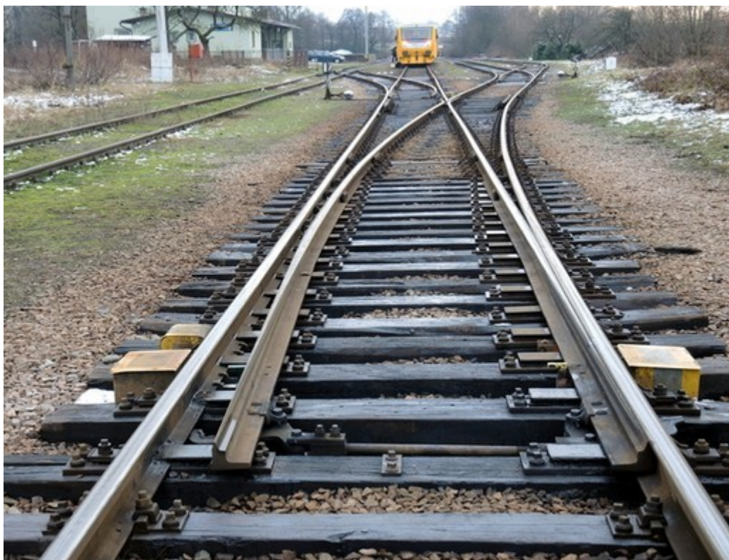
Obr. č. 4: Výhybka č. 8 po MU, postavená v přímém směru na/z 1. kolej, osazení výhybky výměnovými zámkami
