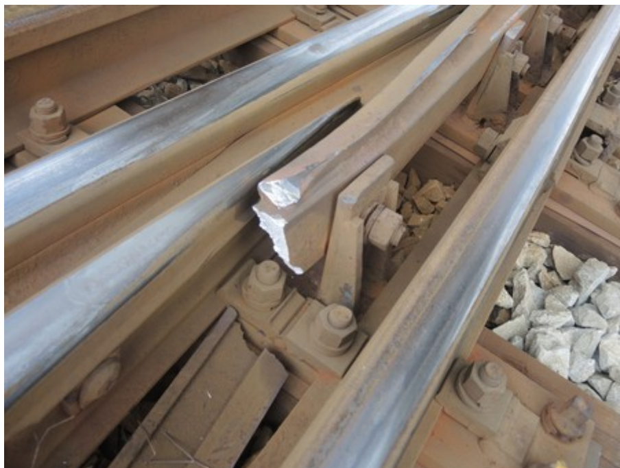
Obr. č. 3: Rozlomená přidrznice srdcovky výhybky č. 25a Zdroj: DI
