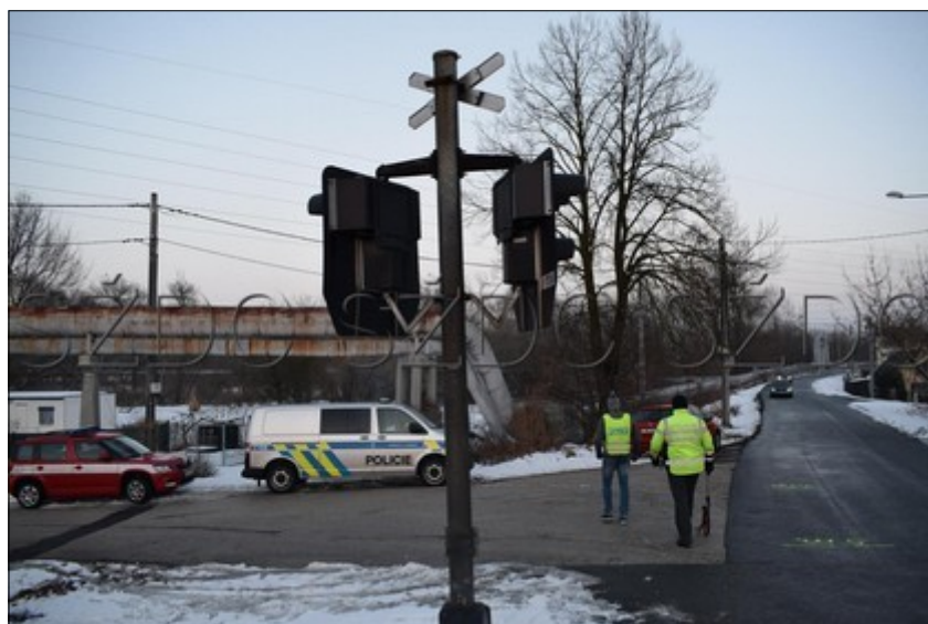
Obr. č. 5: Pohled od ŽP P7724 na násilně vytočenou skříň výstražníku „A1“ proti směru jízdy SMV.
