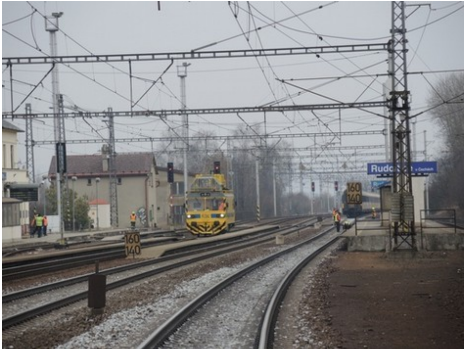
Obr. č. 3: Pohled ze směru jízdy vlaku Ex 1007 směrem k pracovnímu místu u sloupu TV č. 35
