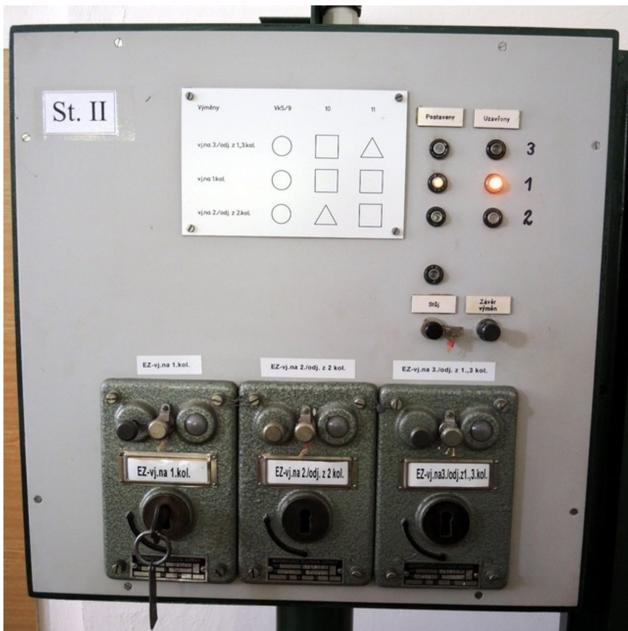
Obr. č. 5: Ovládací deska stanoviště St. II s uzamčeným výsledným klíčem pro vjezd na 1. kolej
