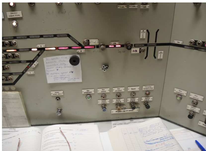
Obr. č. 7: Panel SZZ v žst. Vejpřnice
