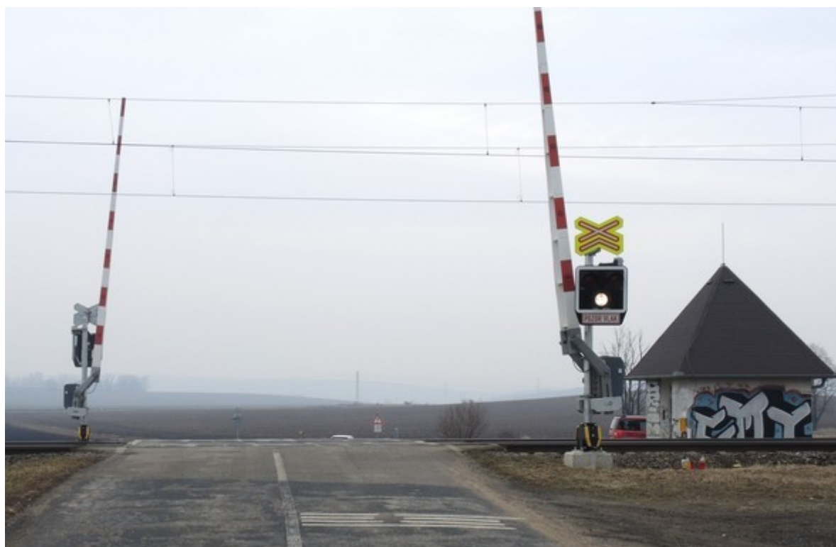
Obr. č. 4: Pohled na PZZ ve směru jízdy OA.
