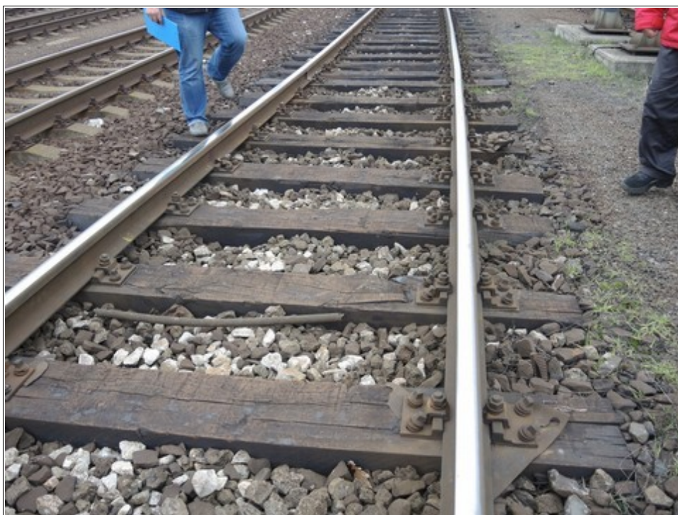
Obr. č. 7: Pohled na vykloněné vrtule R1 v pravém kolejnicovém pásu přilehlém k bodu „0“ DK č. 27 žst. Bohumín – THÚ. Zdroj: DI
