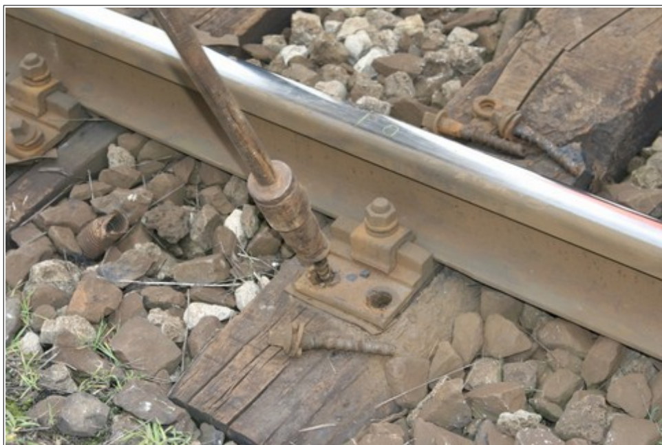
Obr. č. 6: Korozí poškozené vrtule R1 a zteřelá dřevěná kolejnicová podpora v bodu „0“ v pravém kolejnicovém pásu.
