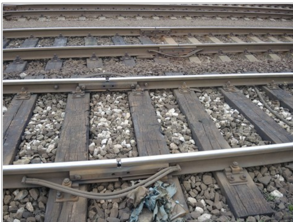
Obr. č. 8: Pohled na kolejnicový styk s převislými konci v pravém a levém kolejnicovém pásu mezi měřicími body „+2“ a „+3“ DK č. 27 žst. Bohumín – THÚ, v němž byla zjištěna dilatační spára překračující povolenou hodnotu. Zdroj: DI
