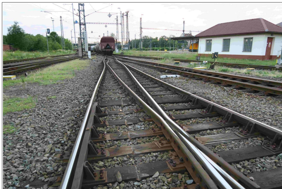
Obr. č. 6: Stav železničního svršku po průjezdu všech DV vlaku Mn 62066
