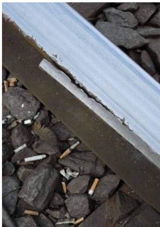
Obr. č. 5: Ukázka stavu rozjeté hlavy kolejnice v obvodu OŘ Brno
