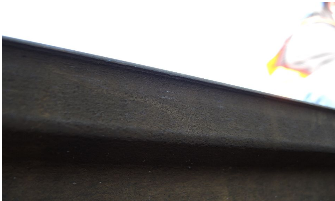
Obr. č. 3: Rozjetá hlava kolejnice v obvodu OŘ Brno
