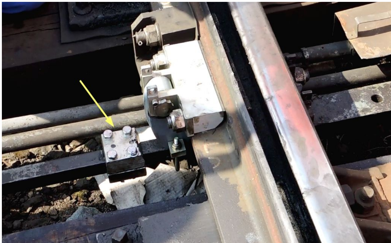
Obr. č. 12: Detail z OP č. 7 - doraz na závorořovací tyči
