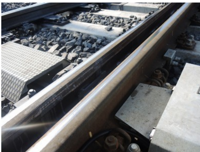
Obr. č. 1: Stopy otěru kol DV mezi jazykem a opornicí – násilného přestavení výhybky č. 19
