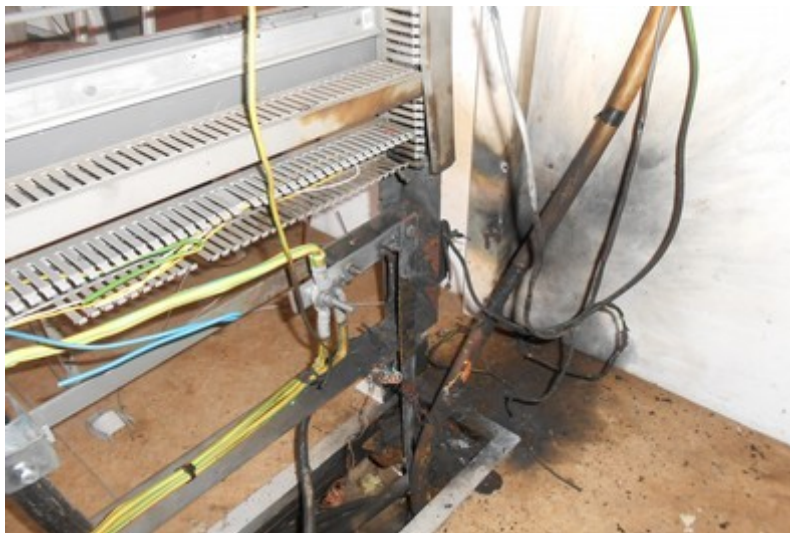
Obr. č. 5: Pohled na zkratované vodiče PZZ P2727 následkem MU.
