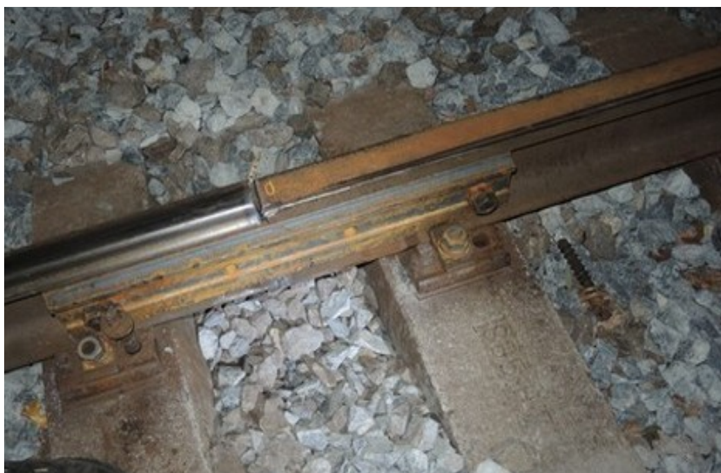
Obr. č. 5: Chybějící spojkové šrouby na spoje kolejnicového styku
