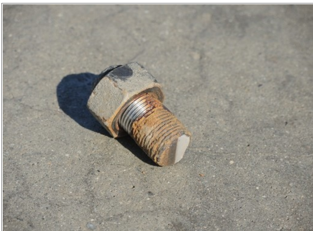
Obr. č. 6: Odlomená část závrtného šroubu s viditelnou korozí (zadní šroub ve směru jízdy), který byl nalezen 92 m před místem MU Zdroj: DI
