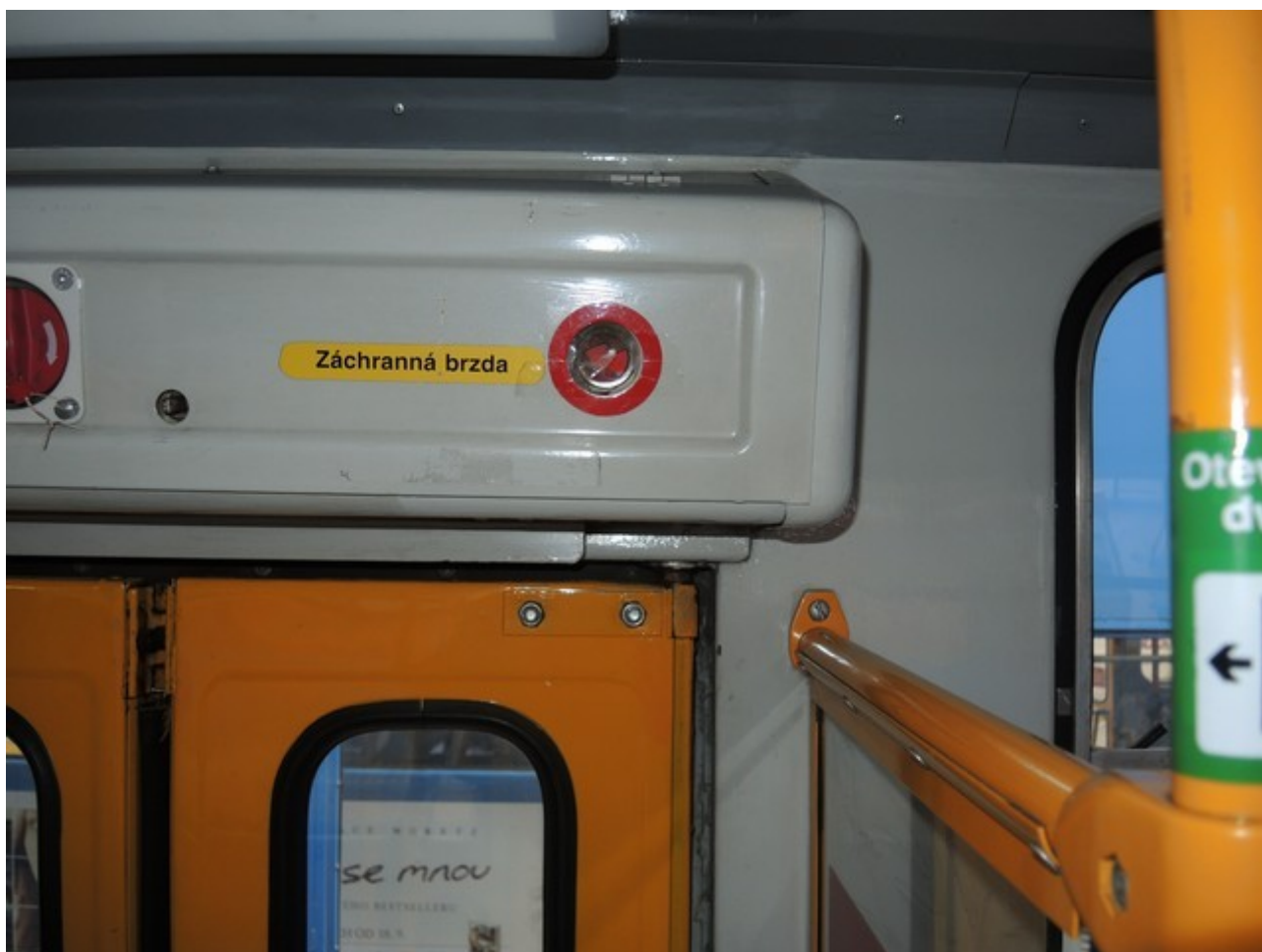
Obr. č. 5: Pohled na poškozenou folii spínače záchranné brzdy, který byl obsloužen cestujícím u prostředních dveří řízeného DV
