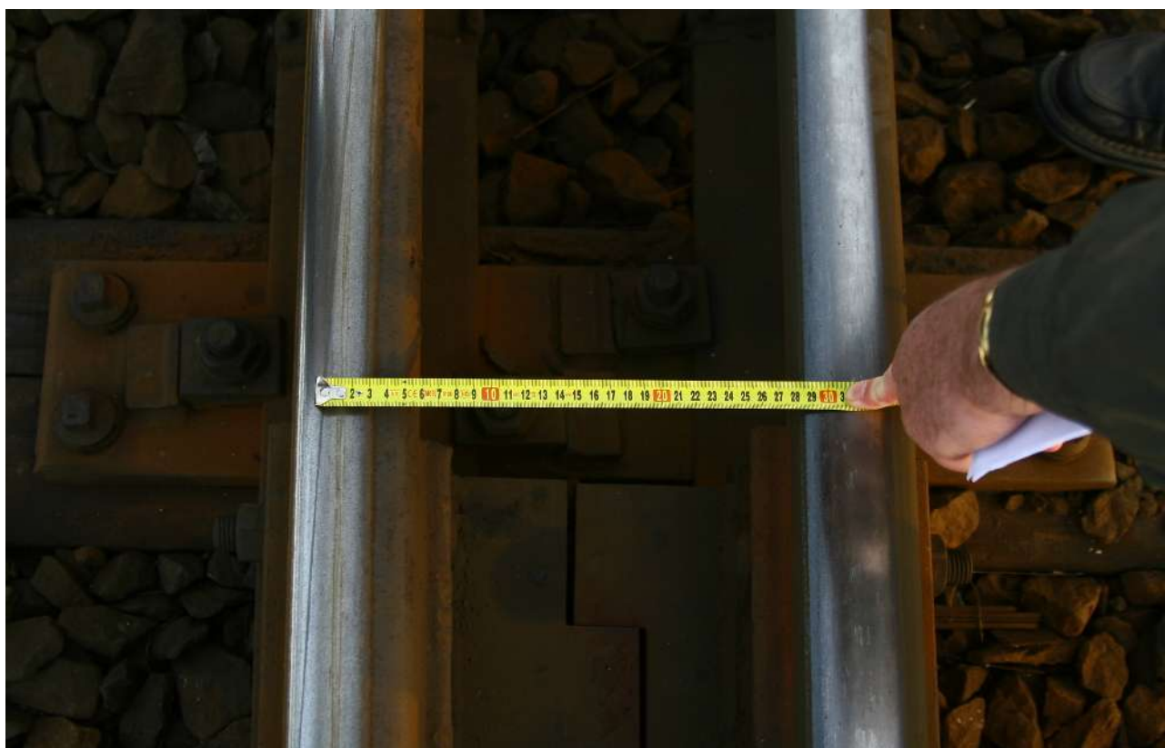
Foto 8: Třetí stopa – tření silentbloku pravé šikmé tyče po odbočné kolejnici výhybky č. 3
