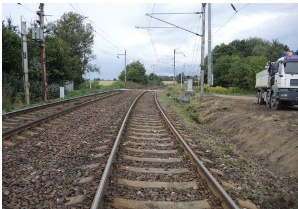
Obr. č. 6: Přejezd P 3703 v km 258,732, místo ujetí svazku kolejových polí
