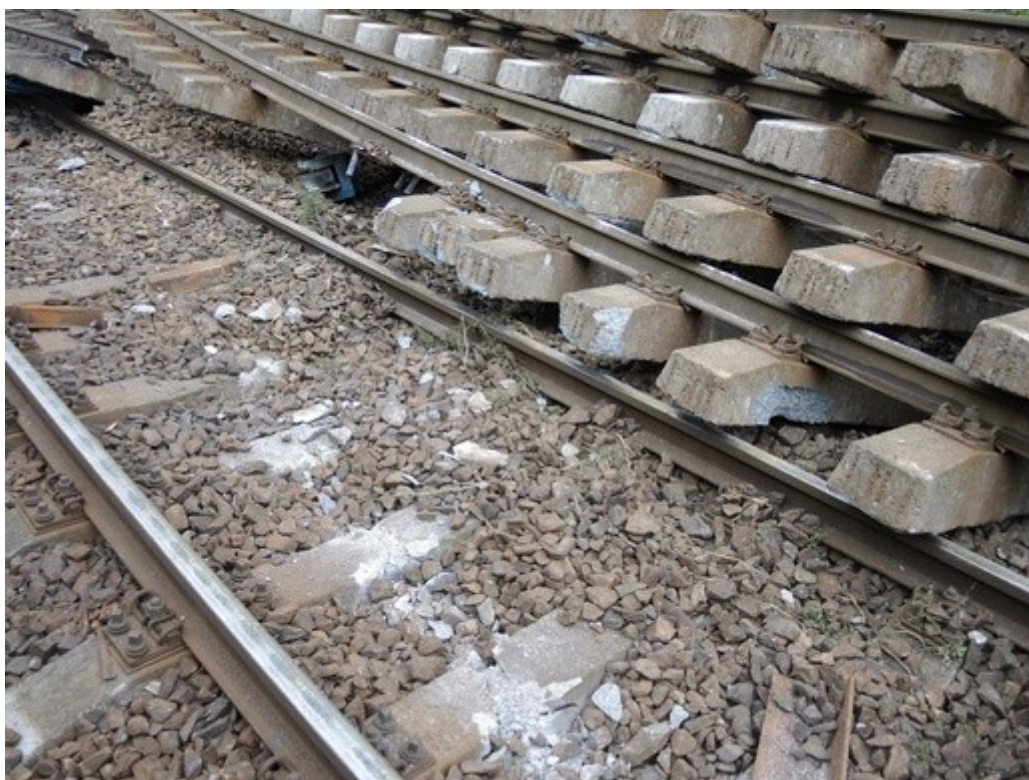
Obr. č. 4: odlomená část podvozku č. 8535 pod sesunutými kolejovými páry a stopy po jeho vykolejení
