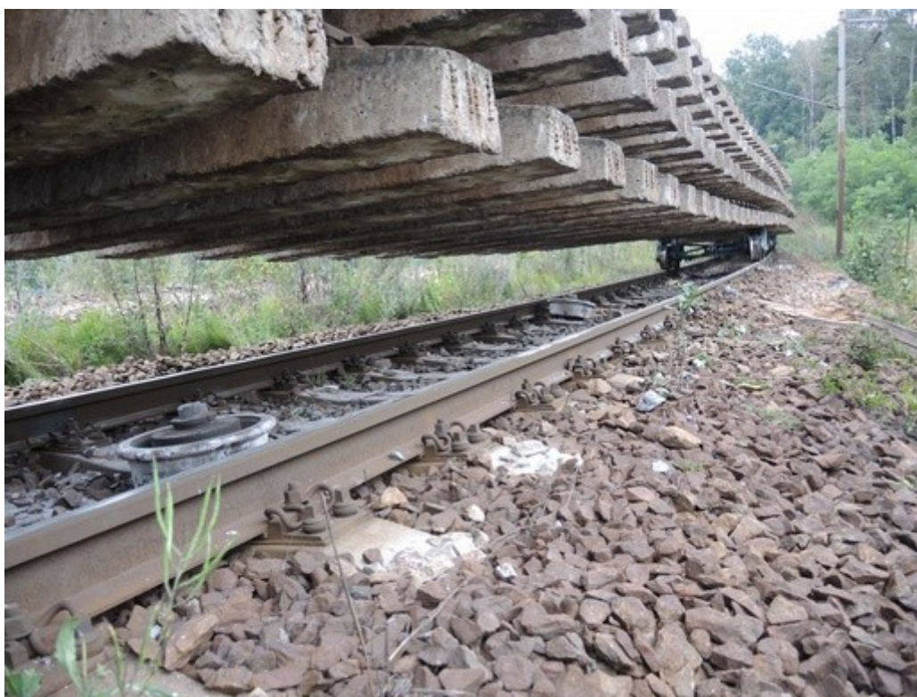
Obr. č. 8: stopy po vykolejení podvozku č. 6029 a součásti podvozku
