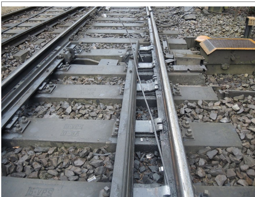
Obr. č. 12: Poškozená výchybka č. 11, pohled ve směru jízdy vlaku. Zdroj: DI
