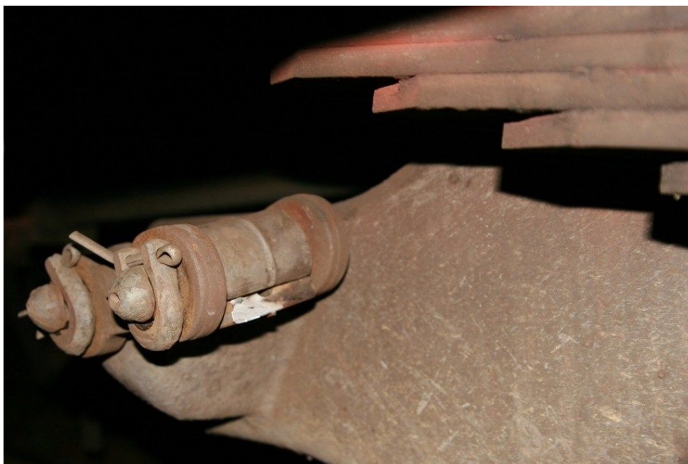
Obr. č. 3: Detail zlomeného hlavního listu pružnice
