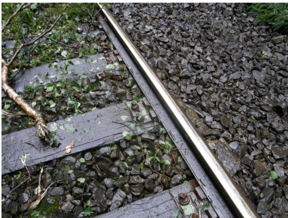
Foto 7: Poškození železničního svršku za bodem „0“
