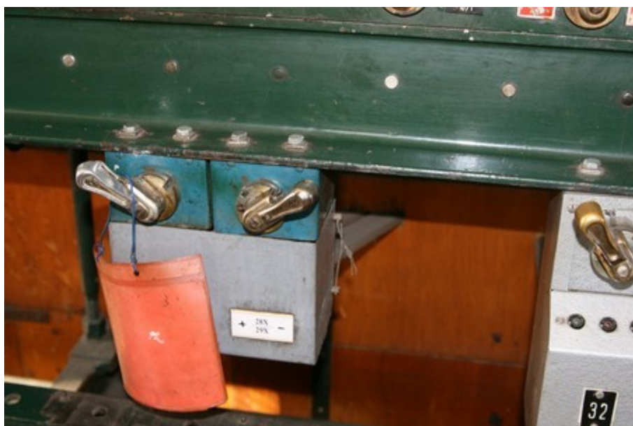
Obr. č. 15: Pohled na řadiče výhybek č. 34/35 a č. 28X/29X
