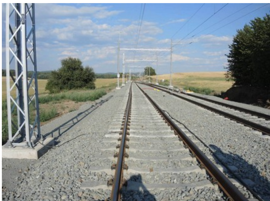
Obr. č. 5: Viditelné boční zvlnění koleje za výhybkou č. 28X Zdroj: DI
