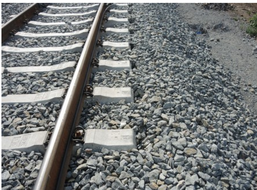
Obr. č. 6: Mezery mezi pražci a štěrkovým ložem na vnějších stranách kolejí Zdroj: DI
