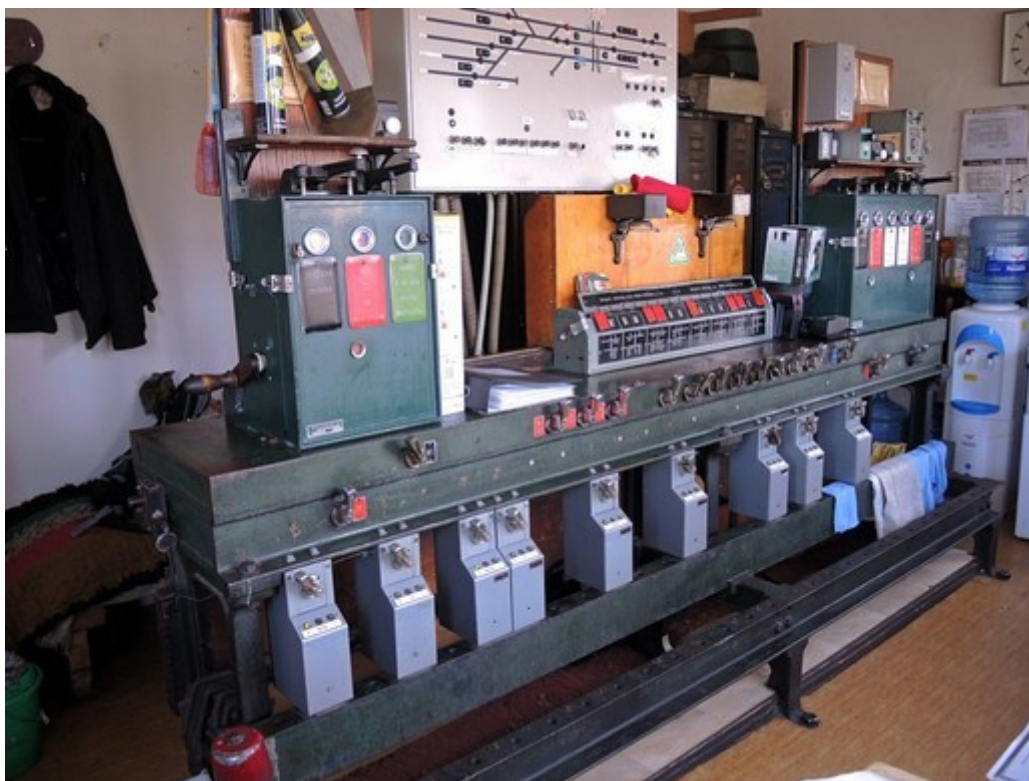
Obr. č. 3: Výhybkářský přístroj St. 2
