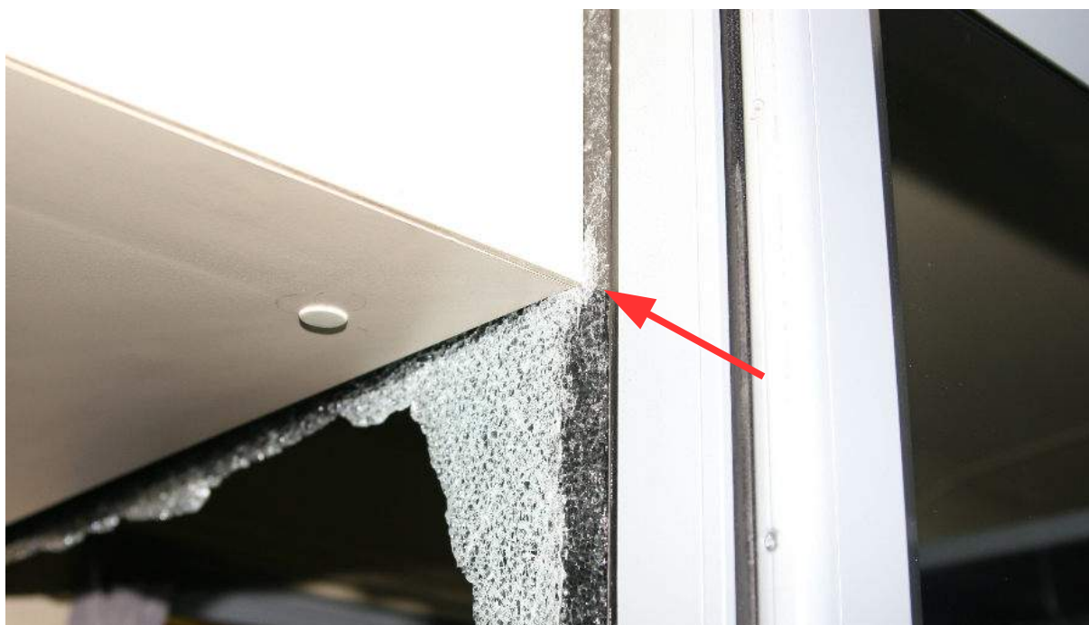
obrázek 11: místo prvotního rozdrčení skleněné výplně pravé přepážky
