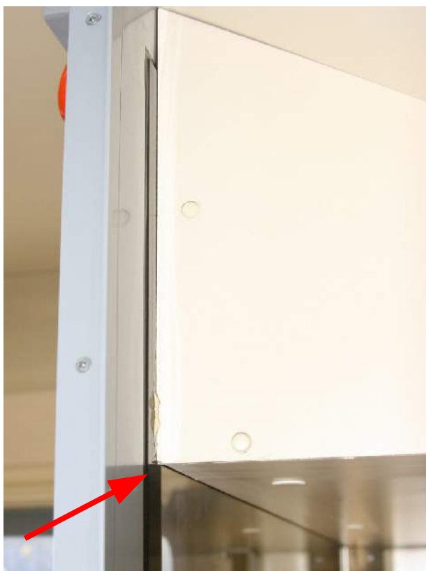
obrázek 21: detail místa dotyku obložení podhledu a příčky
