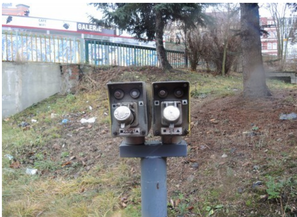
Obr. č. 3: Pohled na elektromagnetické zámky SZZ na karlovarském zhlaví žst. Karlovy Vary dolní nádraží
