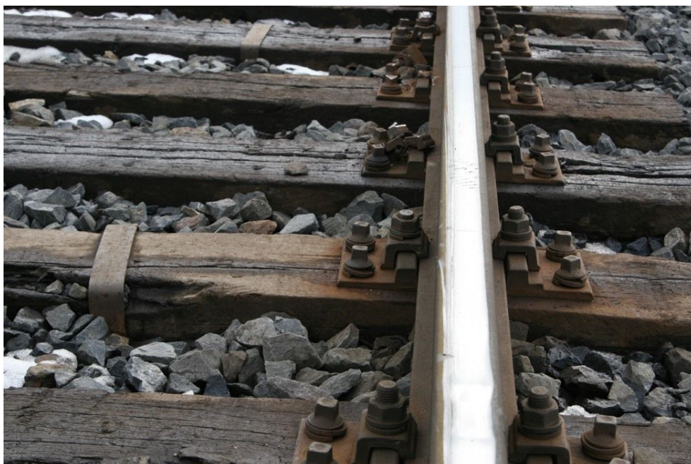
Obr. č. 3: Pohled na „bod nula“ a poškozená upevňovadla Zdroj: DI
