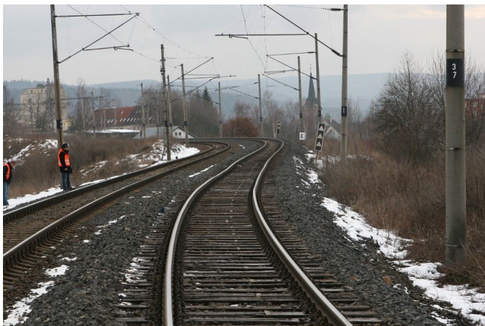
Obr. č. 4: Pohled na 1.TK v bodě nula - viditelná nerovnost koleje Zdroj: DI
