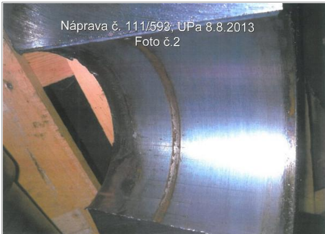
Obr. č. 11: Koroze náboje kola
