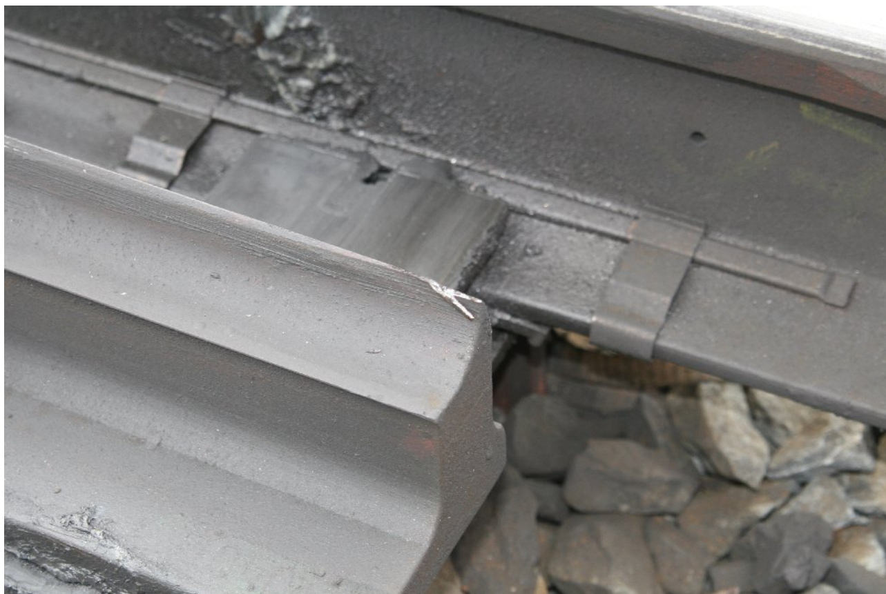
Foto 4: Poškození jazyka výhybky 177N nárazem kola
