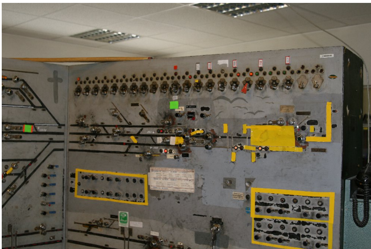
Foto 3: Panel reléového zabezpečovacího zařízení
