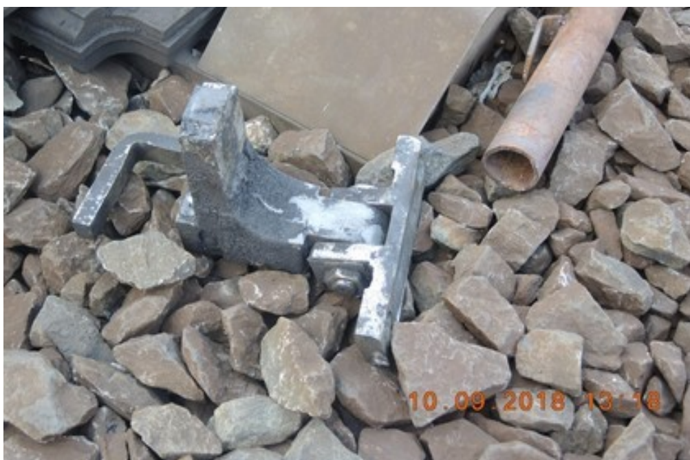
Obr. č. 12: Pohled na nečistoty na povrchu zlomeného závěrového háku pravého vnitřního ohnutého jazyka čelistového výměnového závěru výhybky č. 169a Zdroj: DI
