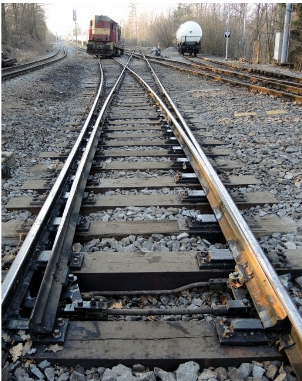
Obr. č. 10: Celkový pohled na vykolejené HDV a výh. č. 2
