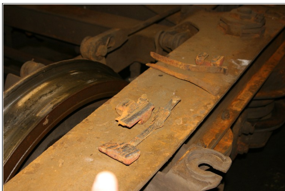
Foto 7: pohled na demontované brzdové špalíky.
