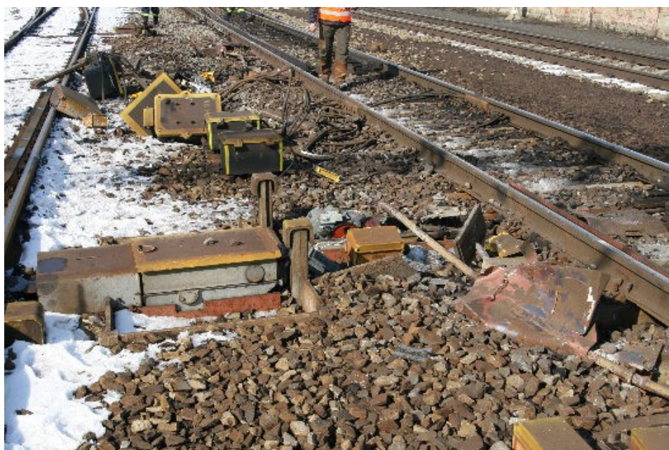
Foto 5: zničené vnější prvky zabezpečovacího zařízení
