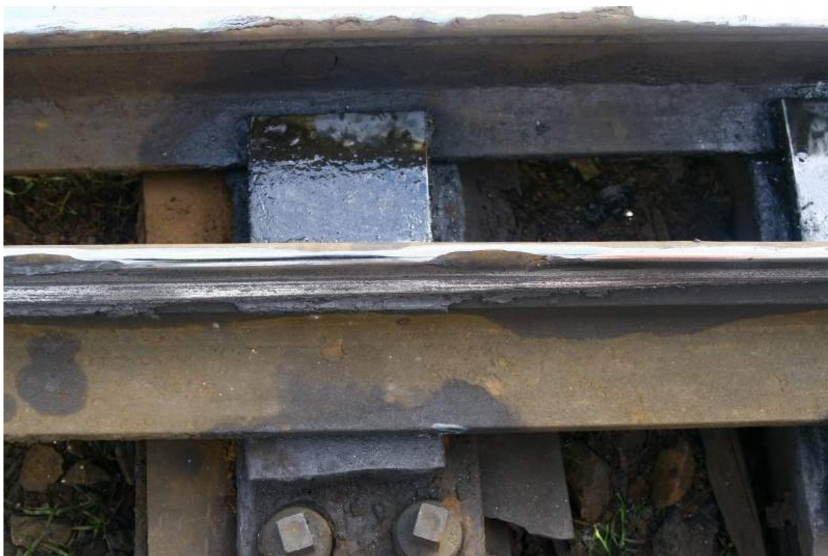
Foto 3: Technický stav jazyka a opornice
