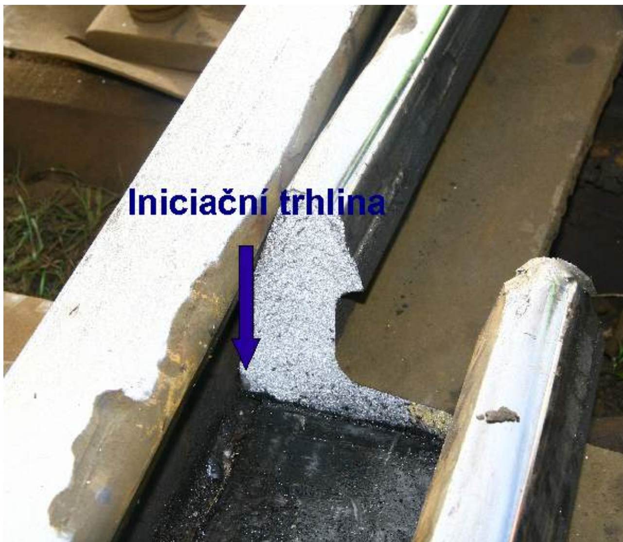
Foto 1: Lom jazyka a iniciační trhlina
