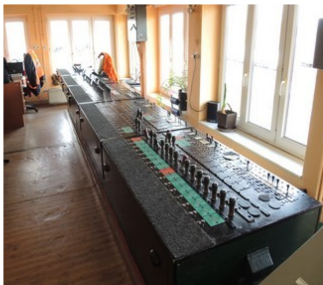
Obr. č. 4: Ovládací panely stavědlového elektrodynamického přístroje: levá část zahrnuje řadiče výhybek, výkolejek a část řadičů seřadovacích návěstidel, v pravé části jsou umístěny řadiče cestových a seřadovacích návěstidel a řadiče souhlasů.
