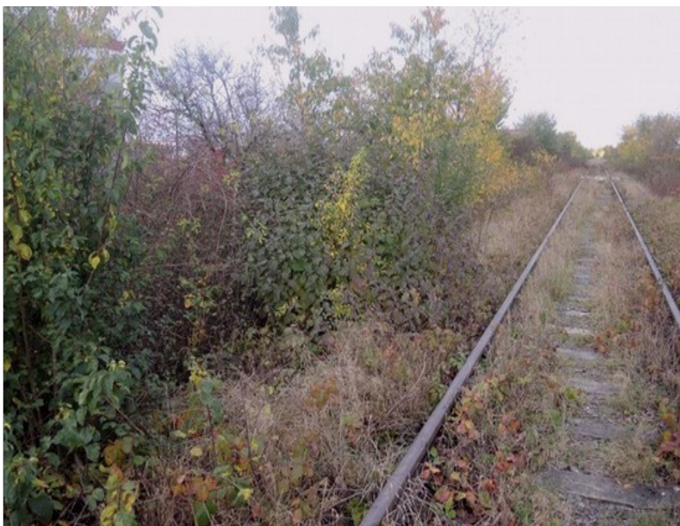
Obr. č. 5: Chybějící volný schůdný a manipulační prostor podél vlečkové manipulační koleje č. 1
