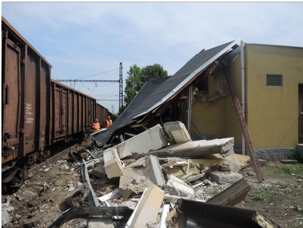
Obr. č. 4: Objekt zničeného stavědla St. 1 žst. Mstětice
