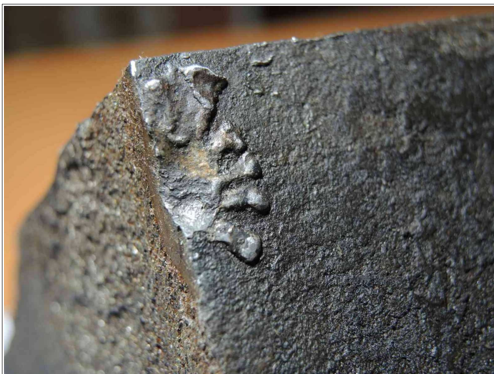
Obr. č. 5: Detail vady na spodní straně paty jazyka výhybky č. 12
