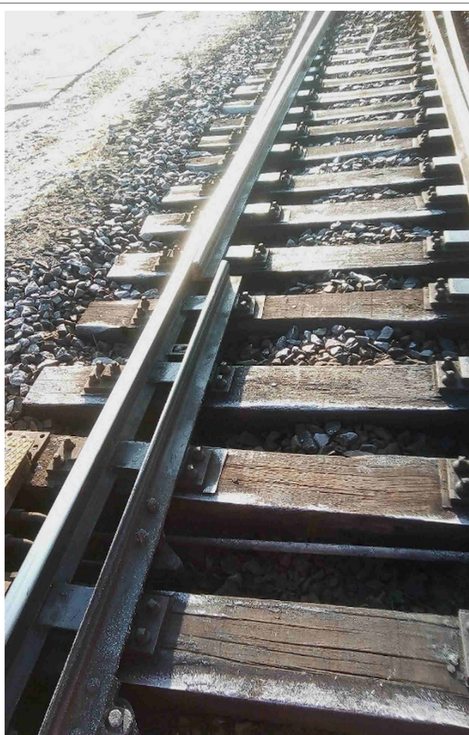
Obr. č. 2: Stav levého jazyka a výhybky č. 12 po MU
