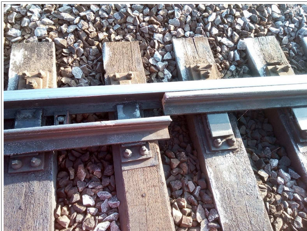
Obr. č. 3: Lom jazyka výhybky č. 12, stav po jízdě vlaku Os 4817
