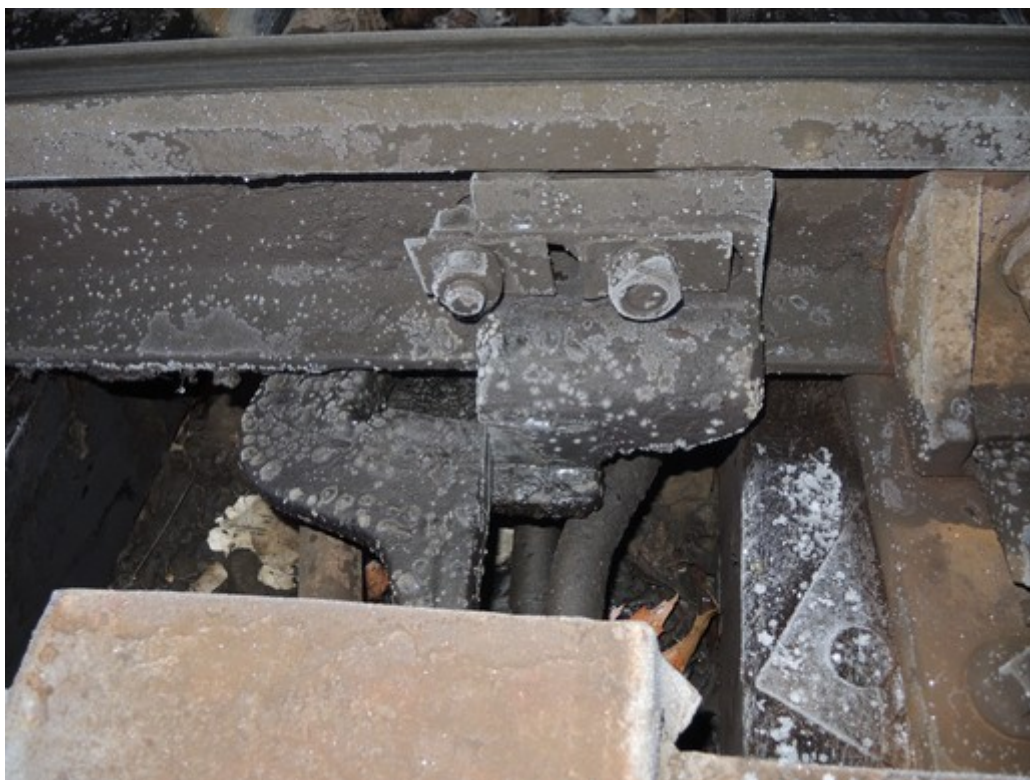
Obr. č. 7: Zákles pravého háku výhybky č. 202a v době ohledání
