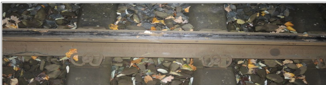
Obr. č. 4: Spadaným listím znečištěné temeno kolejnice 1. TK v km 289,140.
