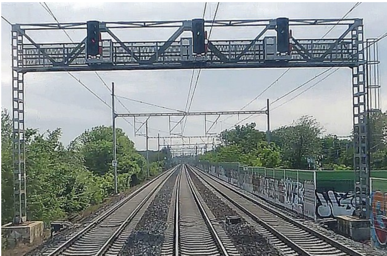
Obr. č. 6: Pohled na situaci na trati v km 395,650 (návěstidlo S0a je vzdáleno 1058 m), kdy vlevo je kolej č. 2a, uprostřed je kolej č. 0a, vpravo je kolej č. 1a a v prostoru za protihlukovou stěnou je poté kolej č. 101a. Návěstidla (Sc1b, Sc0b a Sc2b) na návěsní lávce jsou pouze tři. Zdroj: DI
