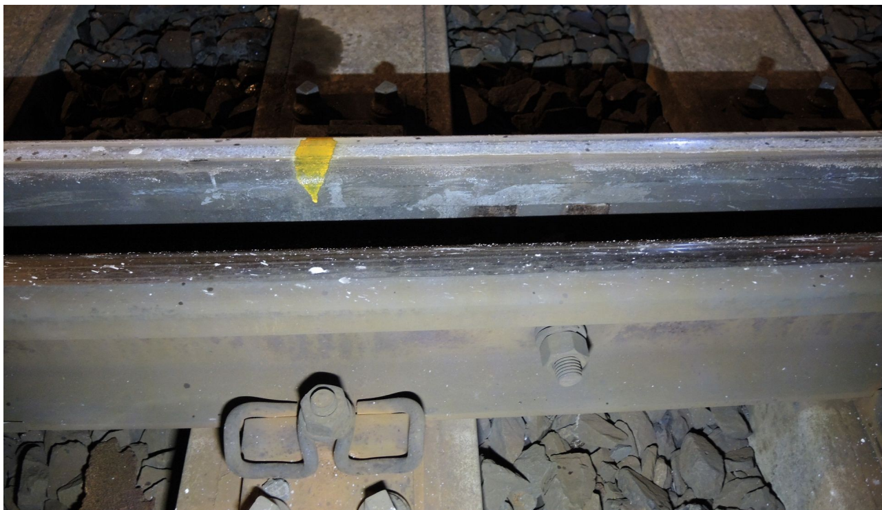
Obr. č. 4: Začátek stop po násilném přestavení výhybky č. 8 jízdu posunového dílu
