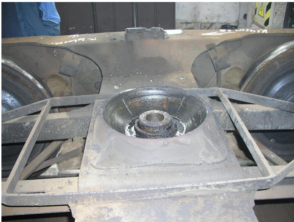
Obr. č. 5: Spodní část torň podvozku „b“ s přítomností vody Zdroj: DI
