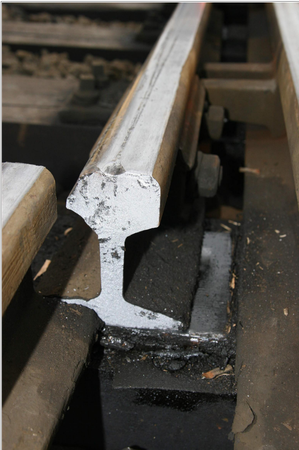
Obr. č. 9: Pohled na lomovou plochu pravého ohnutého jazyka výhybky č. 208 přilehlou ke kořeni jazyka
