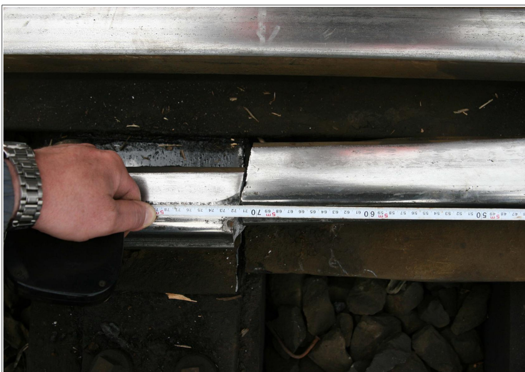
Obr. č. 7: Pohled na lom pravého ohnutého jazyka výhybky č. 208 ve vzdálenosti 5,72 m od hrotu jazyka
