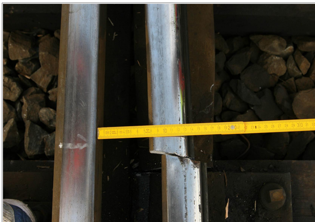
Obr. č. 8: Pohled na lom pravého ohnutého jazyka výhybky č. 208 s viditelnými otlaky kol na temeni jazyka
