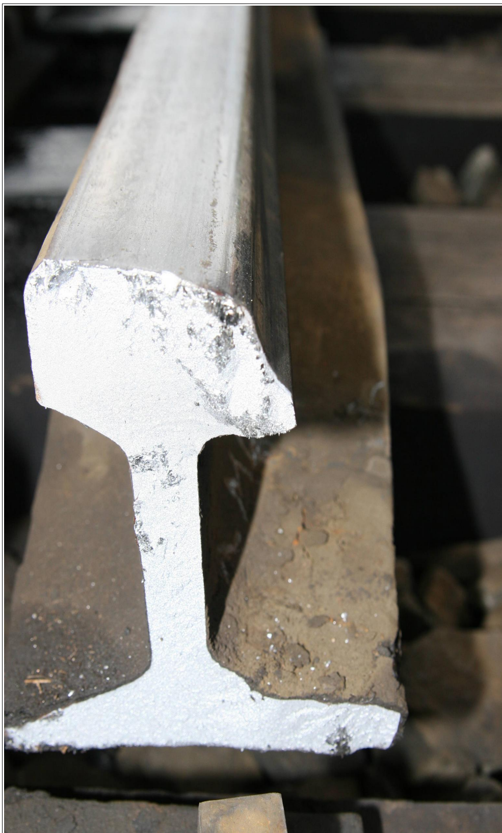
Obr. č. 10: Pohled na lomovou plochu pravého ohnutého jazyka výhybky č. 208 přilehlou k hrotu jazyka
