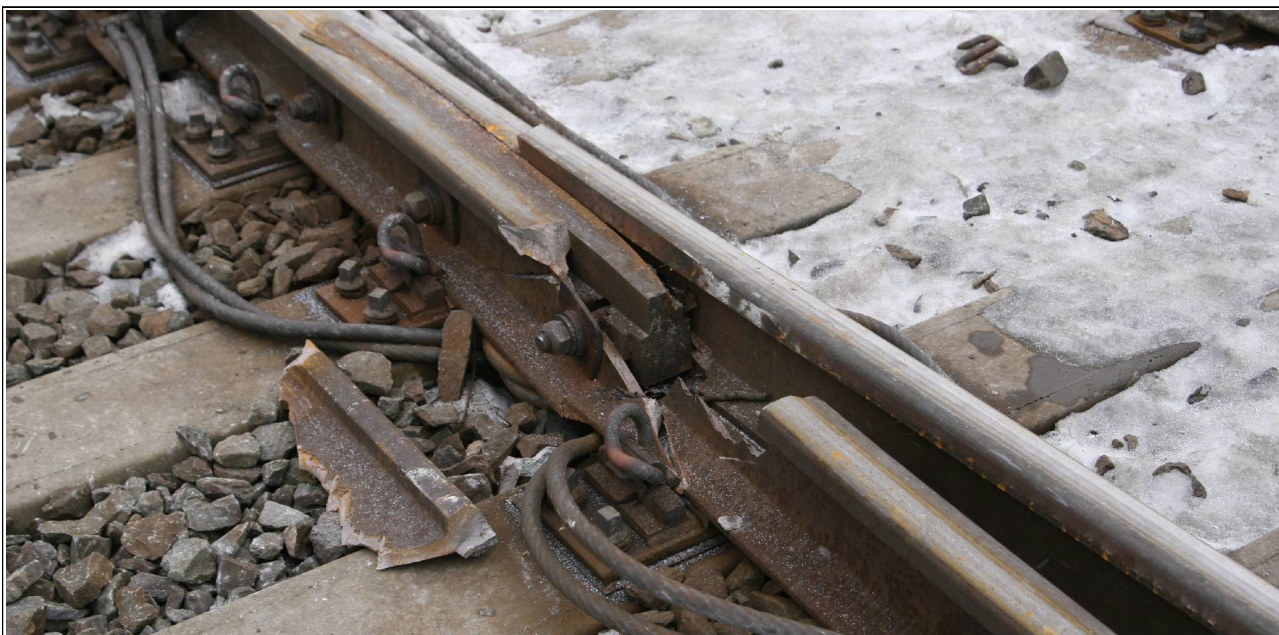
Obr. 5 Snímek ze dne 08. 12. 2010 dokumentující destrukci srdcovky výhybky č. 27 žst. Prosenice po projetí vykolejeného TDV Laaers 23 83 4363 610-2.
