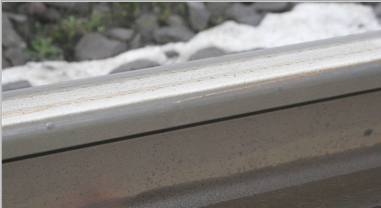
Obr. 4 Snímek ze dne 08. 12. 2010 dokumentuje stopu po vyšplhání kola č. 6 TDV Laaers 23 83 4363 610-2 na temeno hlavy levého kolejnicového pásu traťové koleje č. 2.
